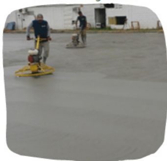
Piso de concreto camurçado
